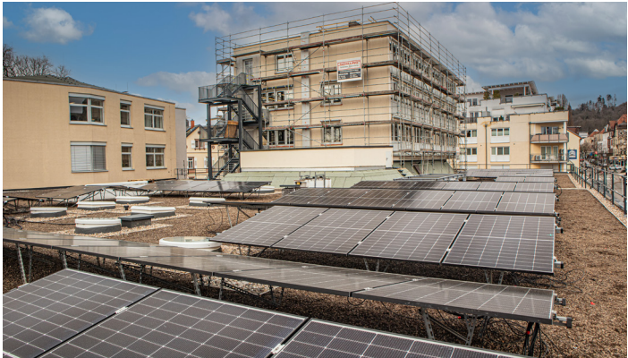
Photovoltaikanlage auf dem Dach der Weinheimer Hauptstelle
