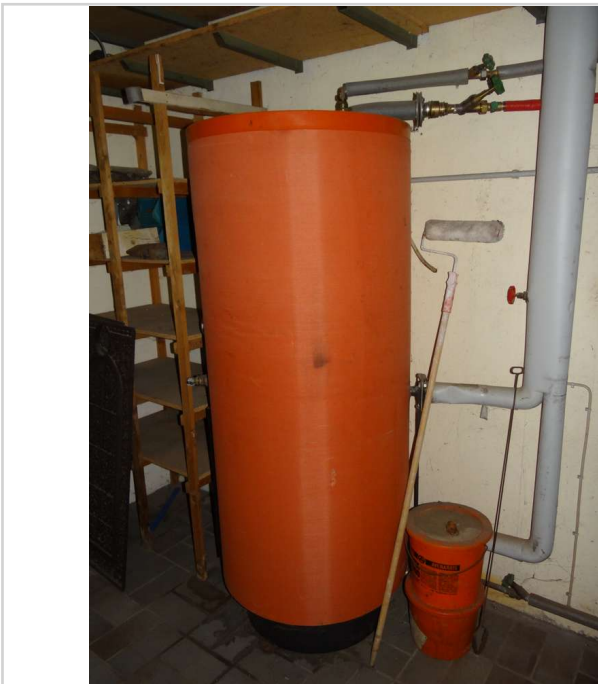
Heizung II Haupthaus
