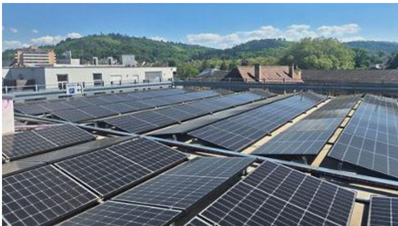
PV-Anlage auf der obersten Etage des Parkhauses.
