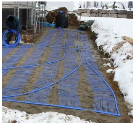
Bodennaher Flächenkollektor einer Sole-Wasser-Wärmepumpe
